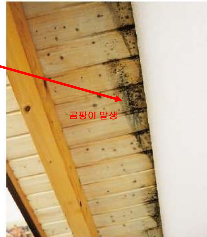
기밀층의 파손으로 인한 처마에 생긴 곰팡이 출처: RWE-Bauhandbuch 13.Ausgabe, germany
